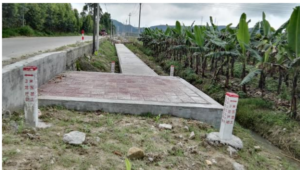
电缆线防护标志
