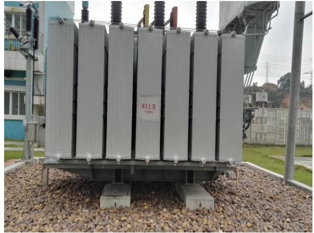
主变压器位置
