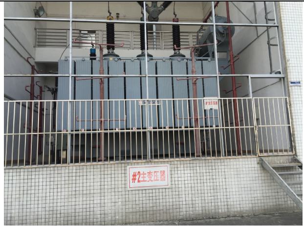
图 3-2 110kV 永康站现有#2 主变
