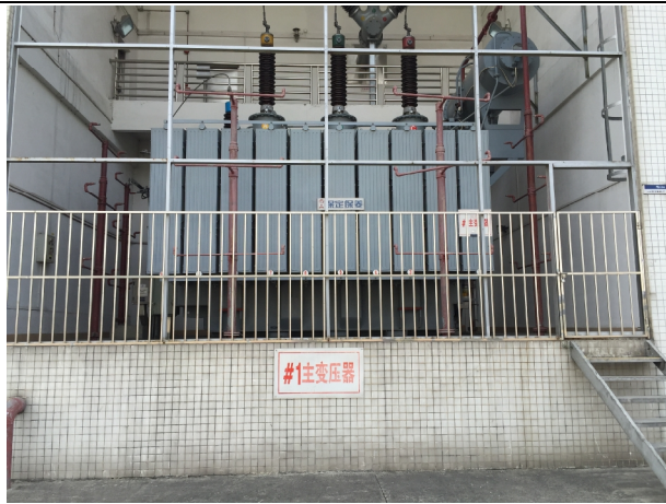
图 3-1 110kV 永康站现有#1 主变
