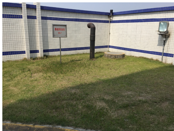
110kV 永康站现有事故油池
