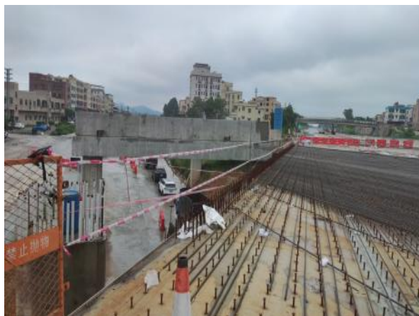
图 1-1 事故现场安全防护栏杆缺失 (注：9 月 24 日现场检查照片)
