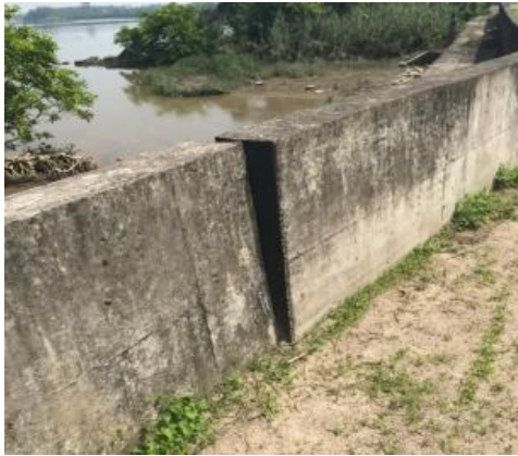
局部防浪墙外倾严重
