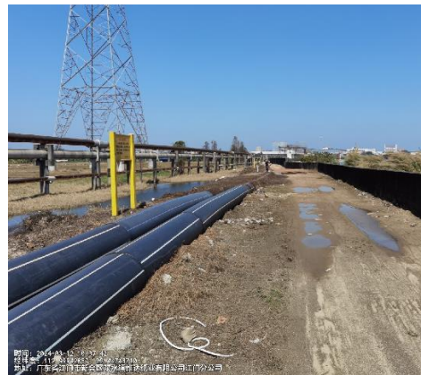
堤顶裸露污水管道
