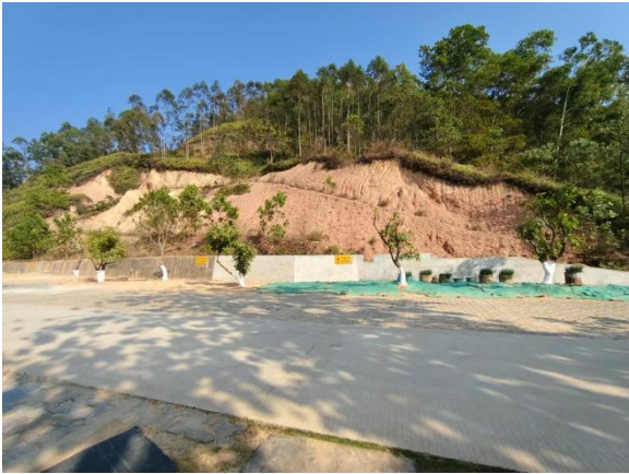
边坡冲塌图一
