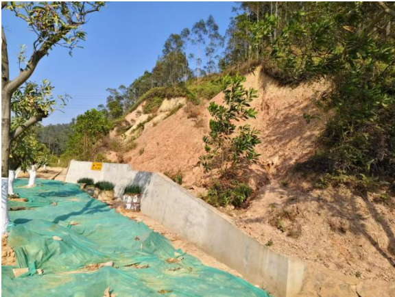
边坡冲塌图二
