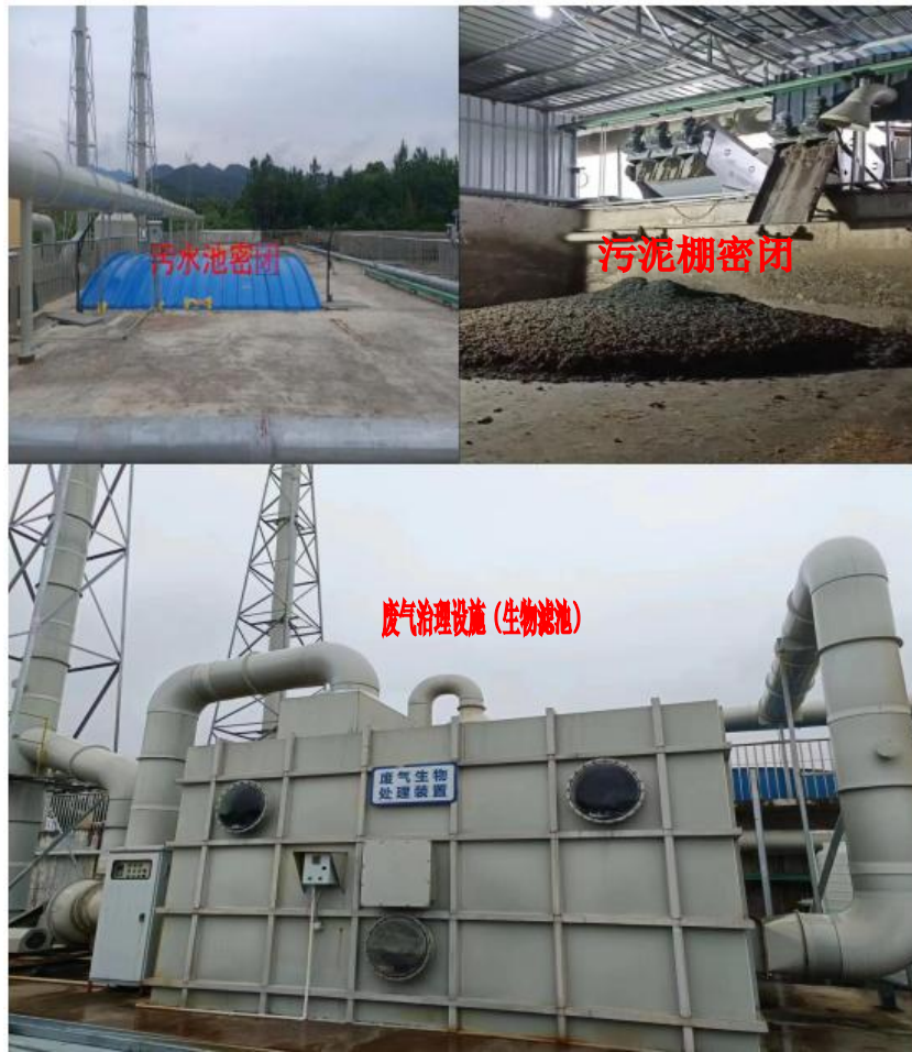
类比项目衢州华统现代化东方生猪养殖建设项目（先行）污水处理站恶臭收集治理设施照片
